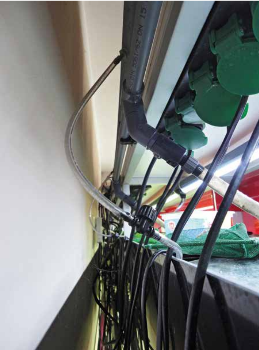
Luftringleitung (oberes Rohr) mit Anschluss zum Aquarium
